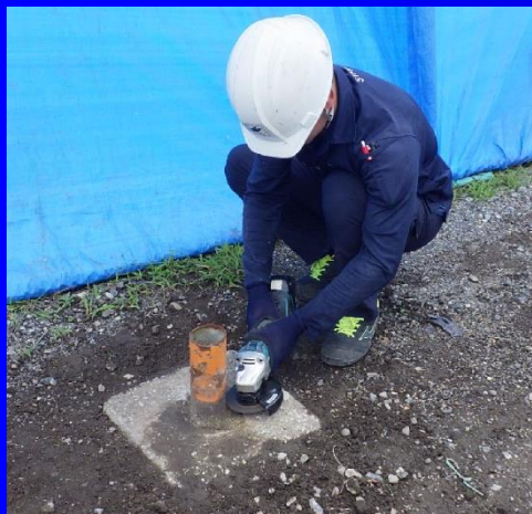
● 破損した支柱切断
