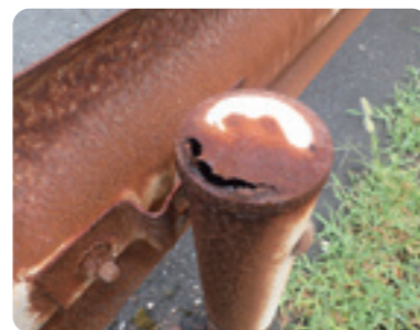
▲腐食が進んで危険な状態の防護柵の支柱
