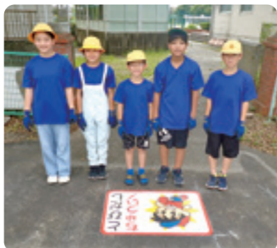
▲美和小学校西門前に施工した「飛び出し注意路面シート」
