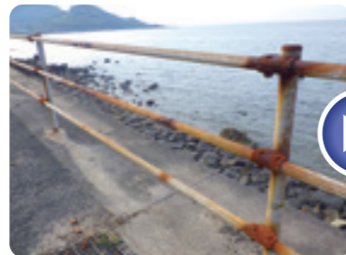
▲錆と腐食が進んだ防護柵
