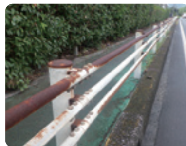
▲錆が進んだ防護柵
